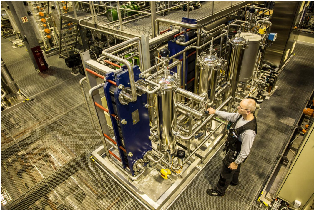
Mynd 3.3 Hjálparkerfi verksmiðjunnar.
