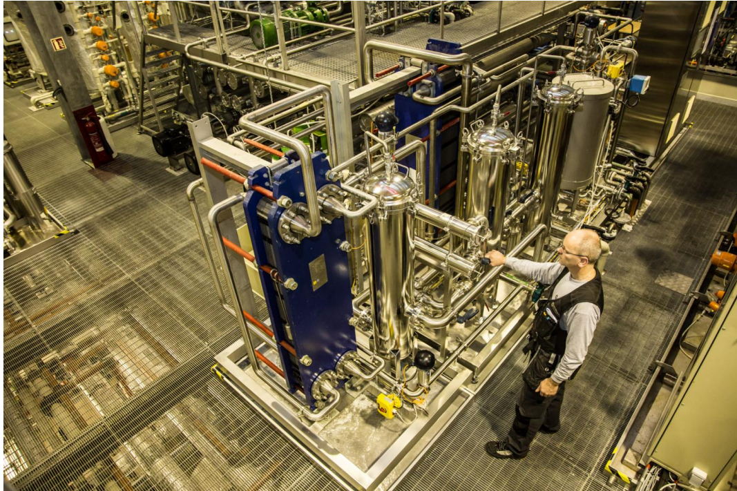
Mynd 3.3 Hjálparkerfi verksmiðjunnar.
